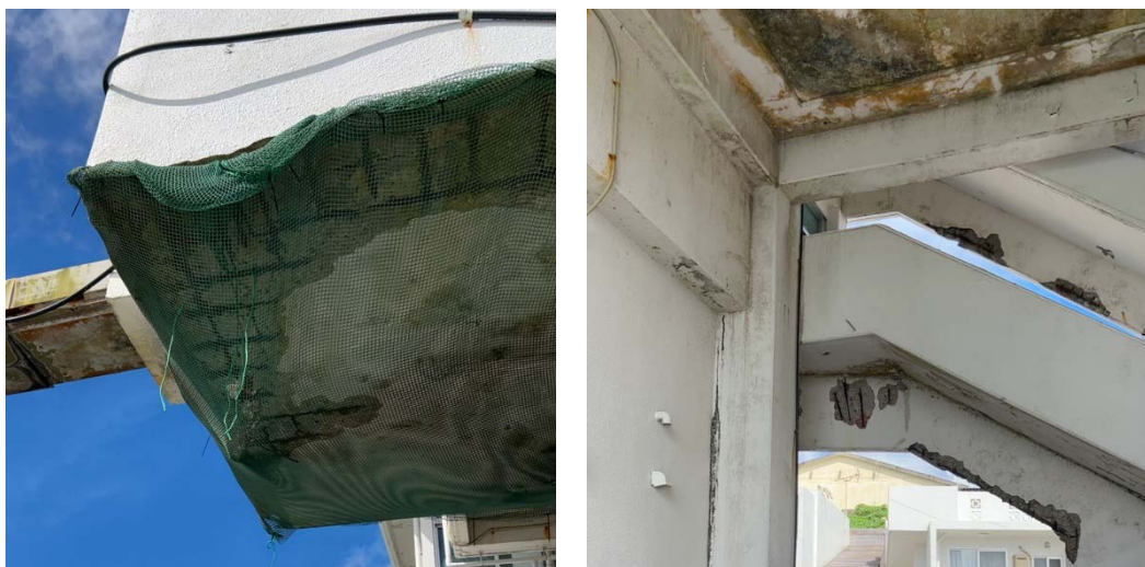
コンクリート爆裂によりコンクリートが剥離し、鉄筋がむき出しになった漁協施設のスラブ・外壁等
