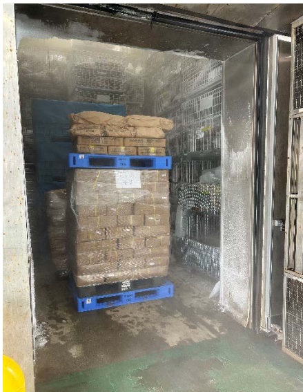
荷捌き施設内冷凍庫
