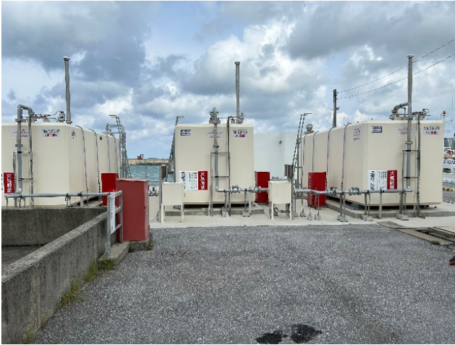
給油施設／コンポルトタンク
